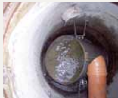
... der Bottich kippt (Zulaufrohr im Schacht verlängert)
